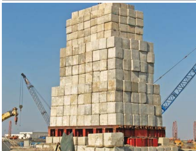
Fot. 4. Stanowisko balastowe 20MN
